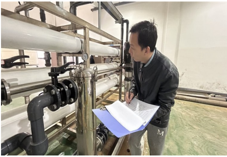
工作人员正在检查企业水处理设备
