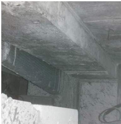
图为吊顶里的分户墙与顶梁之间留着约40厘米的大豁口。
